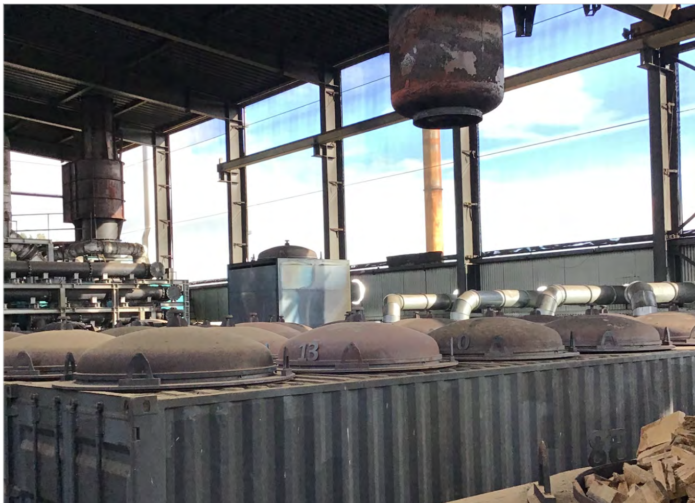
Retorten der Pyrolyseanlage von der Green Carbon GmbH in Üllitz
