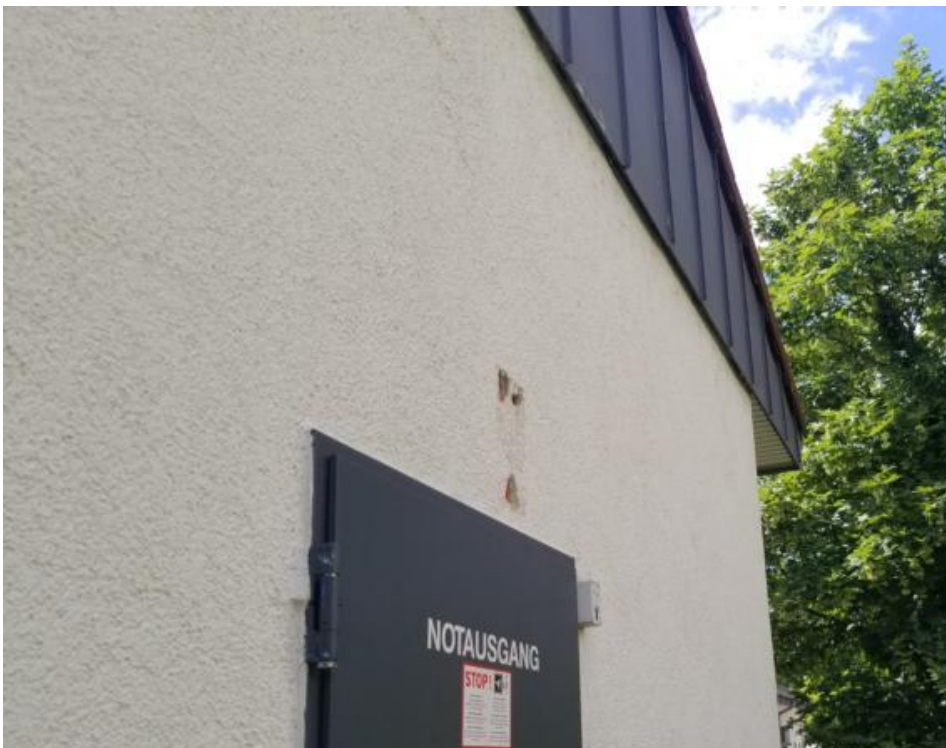
Abbildung 6: Flachgründige Löcher in der Gebäudefassade.
