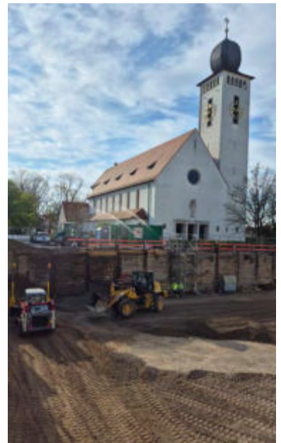
Die Baugrube St. Laurentius wird aktuell teilweise wieder verfüllt. Foto: Marcel Winter/Stadt Bretten
